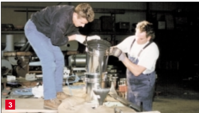
Über einen Trichter wird das Harz eingegossen. Um einen gleichmäßigen, fehlerfreien und schnellen Verguß zu gewährleisten, wird der eingeschaltete und abgedichtete Hohlraum zwischen Stahlplatte und Betonfundament mit einer Vakuumpumpe evakuiert und das Harz praktisch "eingesaugt".
